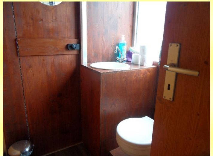
Waschgelegenheit mit Wassertoilette ...
